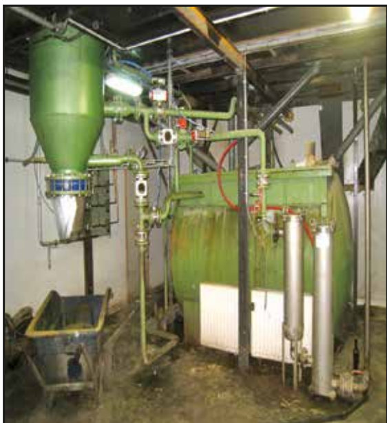
Cuve et bas du filtre
